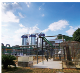
桂林南药污水处理系统
